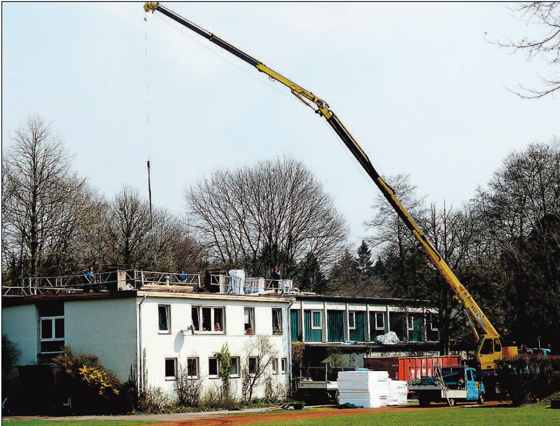
Der Austausch des in die Jahre gekommenen Daches der Turnhalle Wermecker Grund hat begonnen. Die Sanierung kostet rund 60 000 Euro. ■ Foto: Kleinfeld
